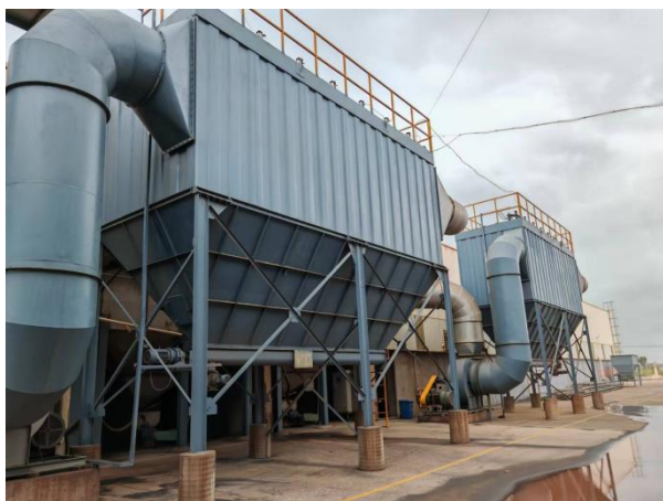
钛矿石榴石车间、锆英金红车间废气处理装置
