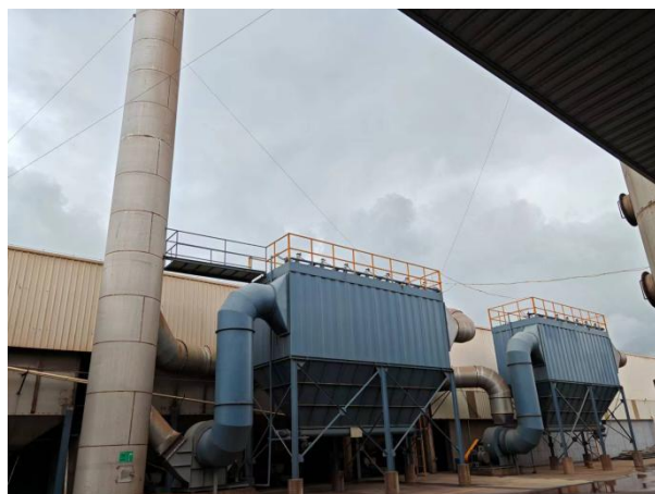
钛矿石榴石车间、锆英金红车间废气排气筒
