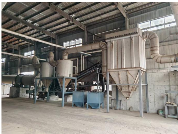
烘干车间一废气处理装置
