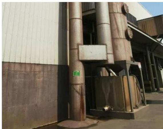
烘干车间一废气排气筒
