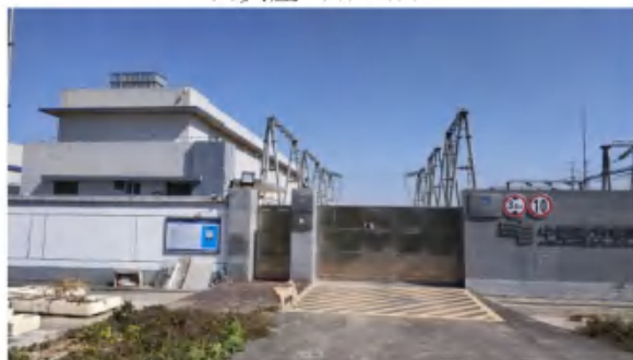
110千伏圩河变电站 (W)
