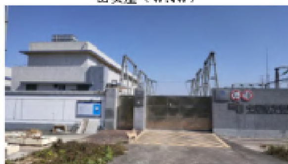
110千伏圩河变电站 (W)
