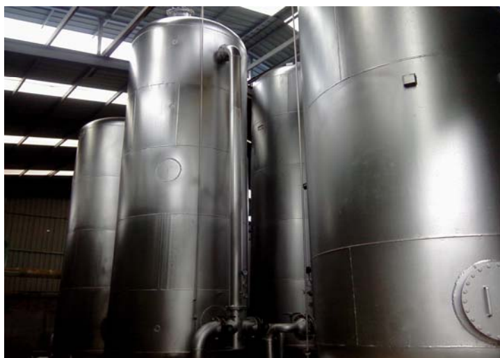
图 4.3.5.5 5000 吨/天工程过滤塔
