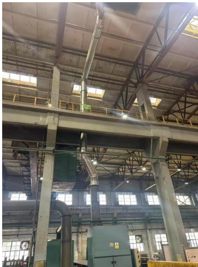
图 2.4-1 现有工程排气筒 P1（DA001）及布袋除尘器图
