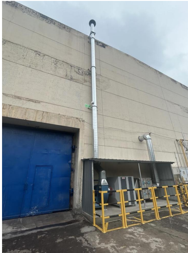
图 2.4-1 现有工程排气筒 P2（DA002）及油烟净化器+干式过滤箱图
