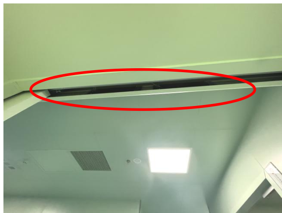
M3 (辐射工作人员、受检者进出防护门) 门-机联锁装置
