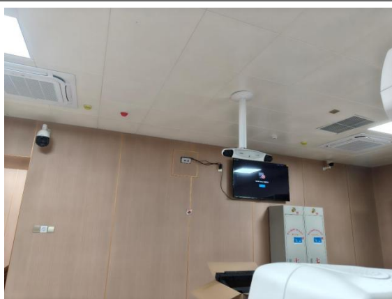
机房内监控及送风口
