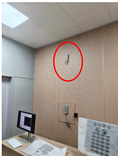
加速器治疗室(1)迷道内南侧固定式辐射监测报警仪探头
