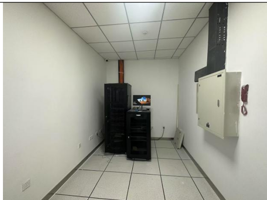
加速器治疗室(1)东侧网络机房
