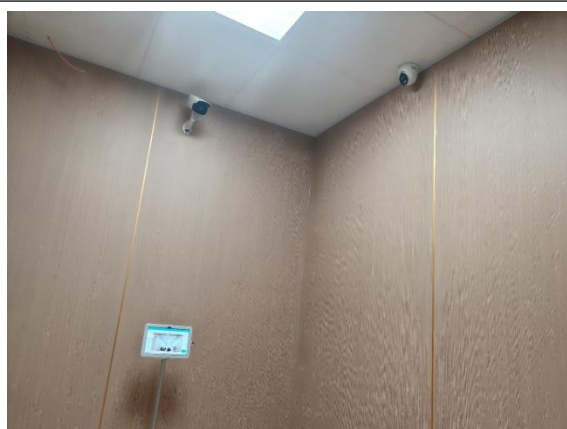
机房内迷路入口监控
