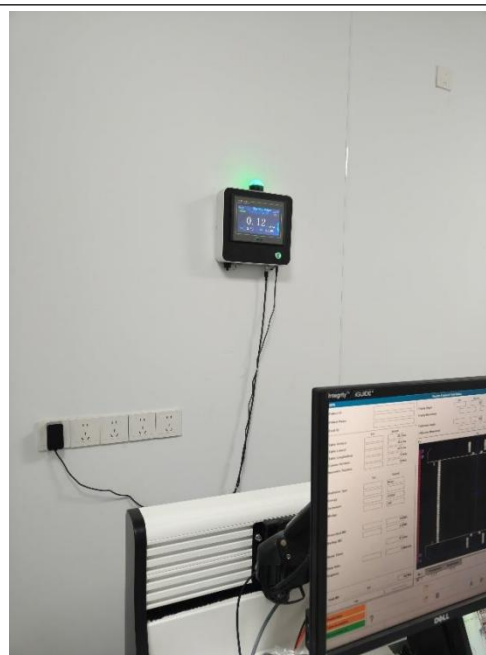
控制室内南墙固定式辐射监测报警仪显示屏
