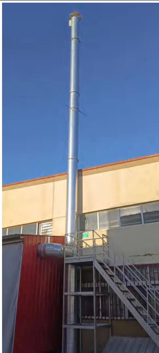
图 6 排气筒 P1 采样平台及其规范化标识牌照片
