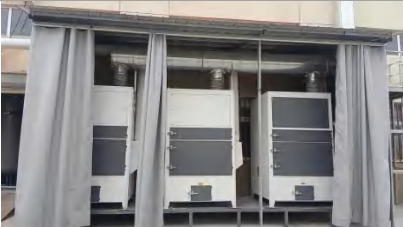
图 4 三台数控喷砂机集气收集、除尘照片
