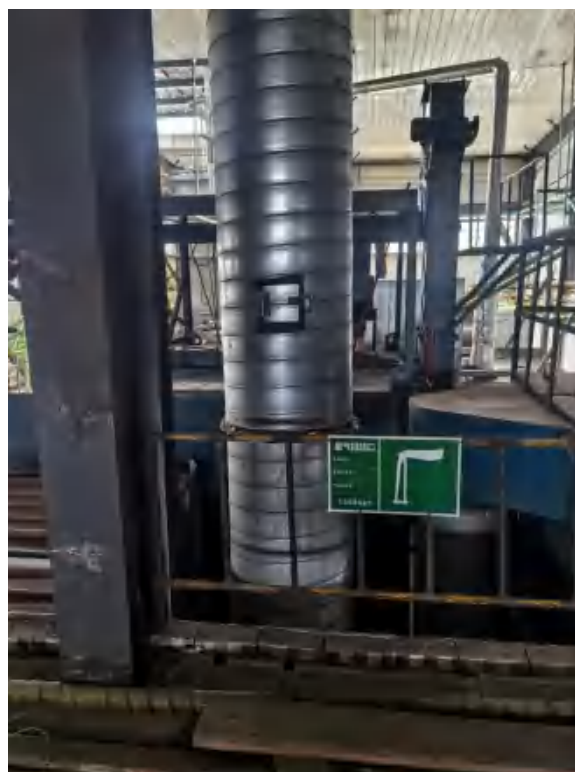
图 14 排气筒 P1 除尘器、检测孔及规范化标识牌照片
