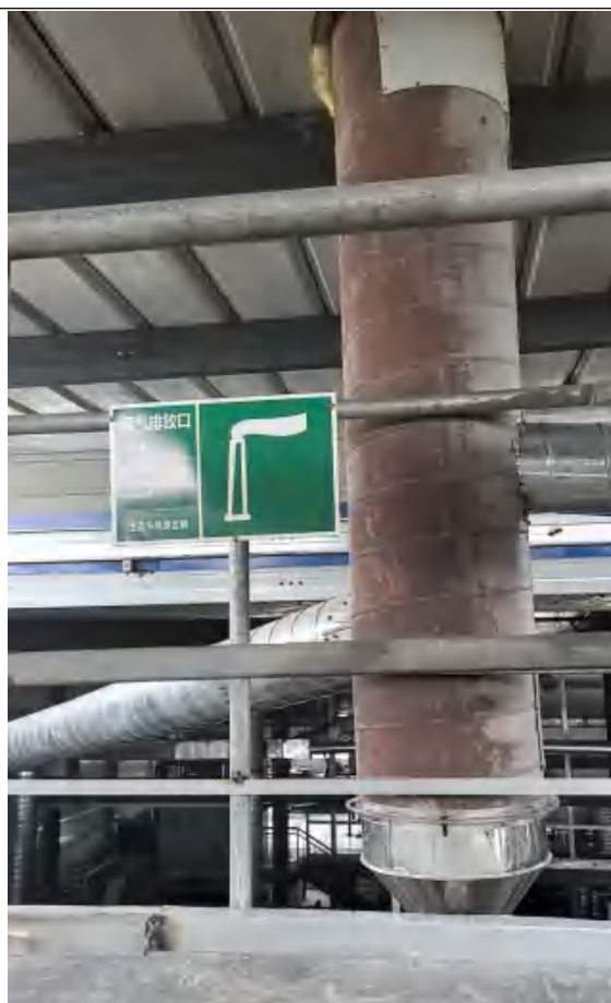
图 15 排气筒 P2 检测孔及规范化标识牌照片
