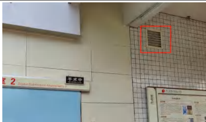
排风口外部照片
