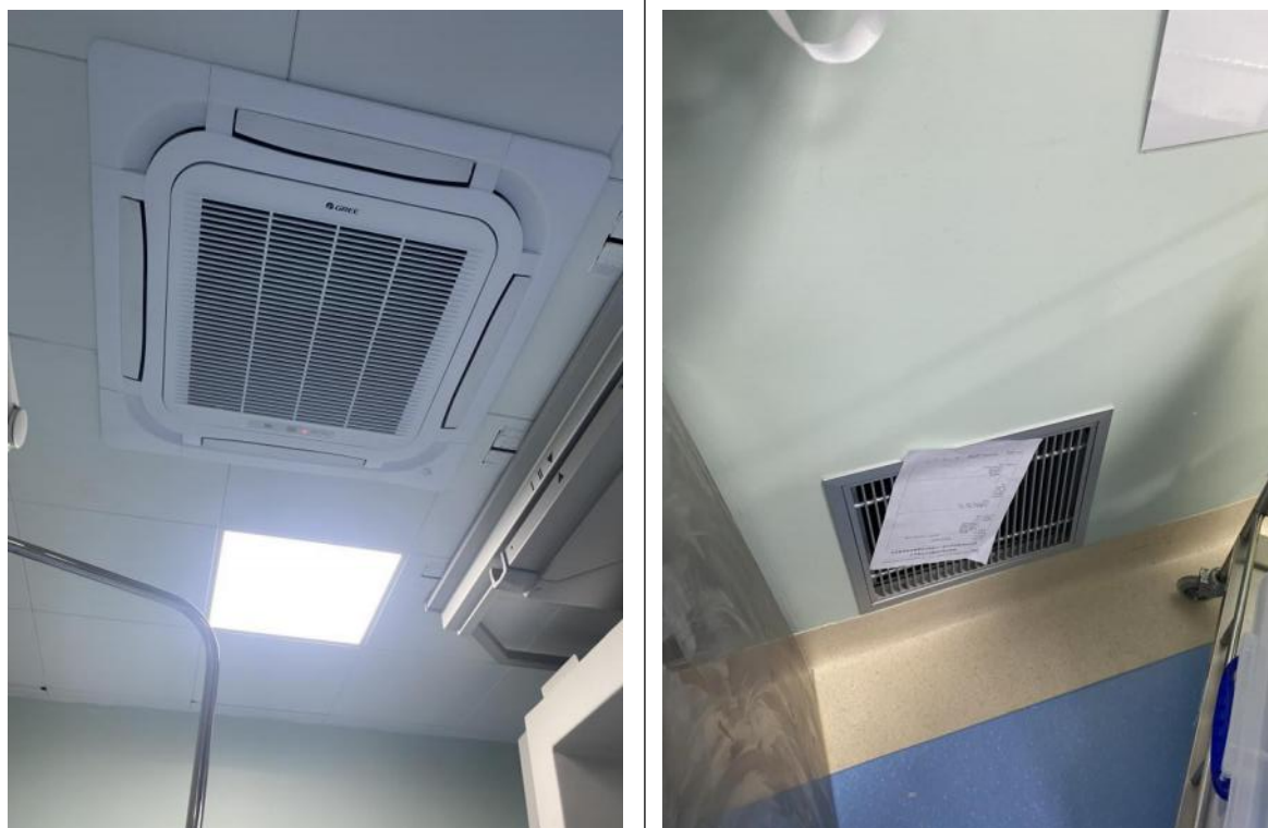
图 3-5 本项目机房通风设置现场照片
