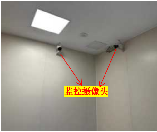
迷宫内入口监控摄像头
