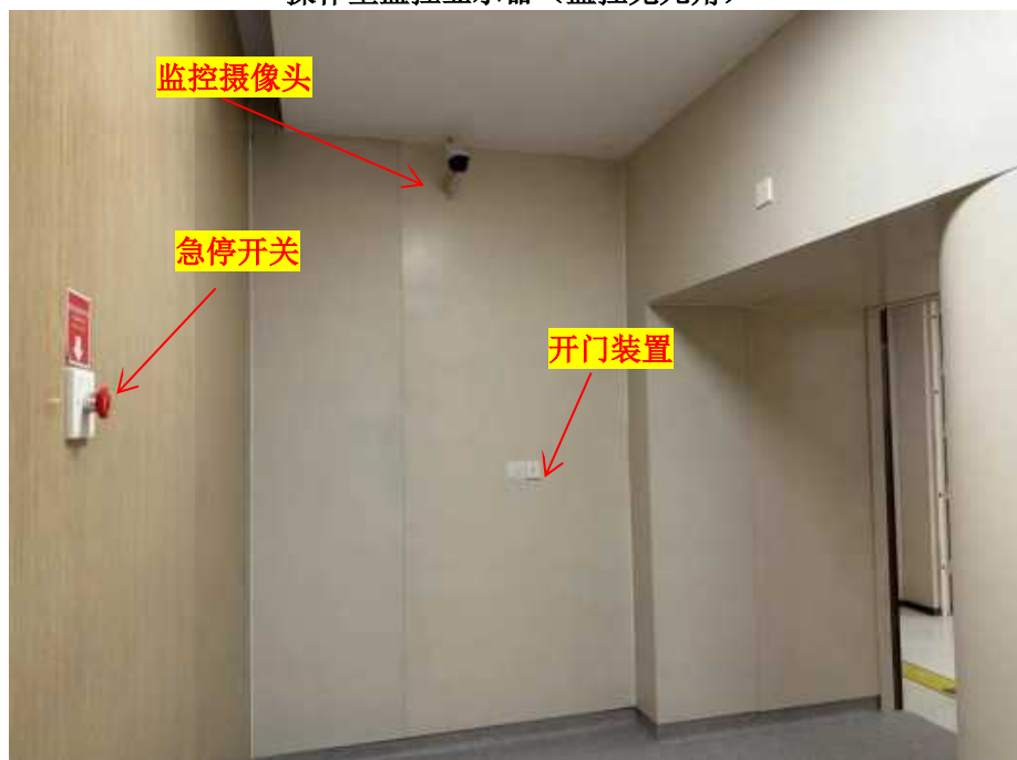
迷宫外入口监控摄像头、开门装置、急停开关
