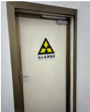
操作室防护门及自动闭门装置
