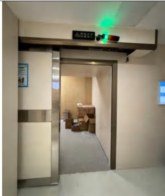
机房大门打开状态
