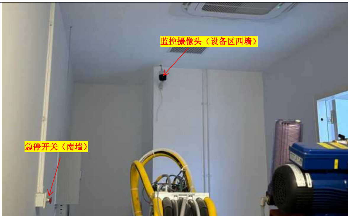
设备区南墙的急停开关、西墙的监控摄像头
