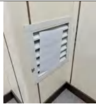
CT 模拟定位室下排风口
