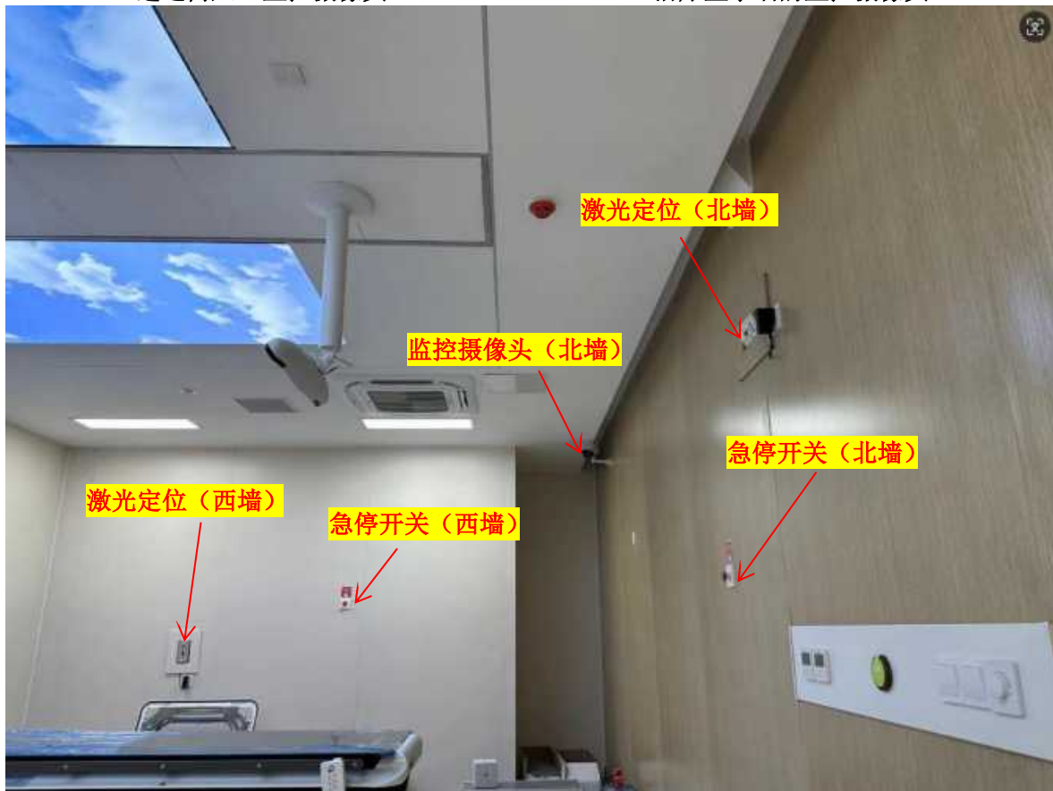
治疗室北墙、西墙的急停开关、监控摄像头、激光定位装置
