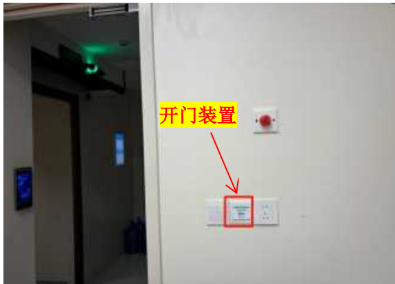
操作室内防护门开关
