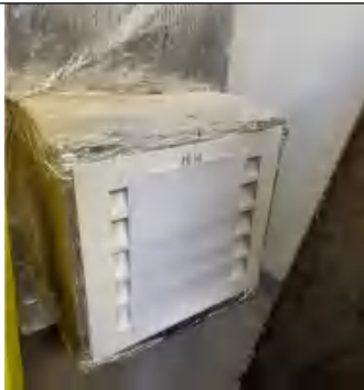
1号直加治疗室下排风口 (位于设备区内)
