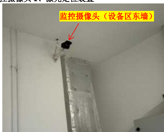
设备区东墙的监控摄像头
