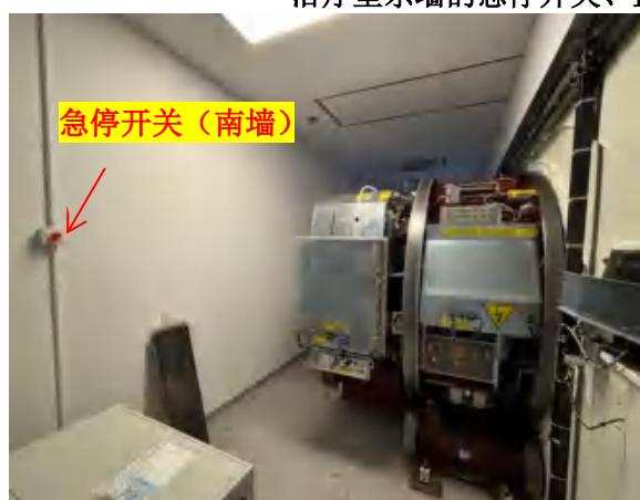
设备区南墙的急停开关
