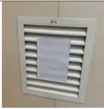
1号直加治疗室下排风口(位于治 疗室内)
