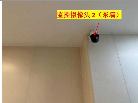
治疗室东墙的监控摄像头 2
