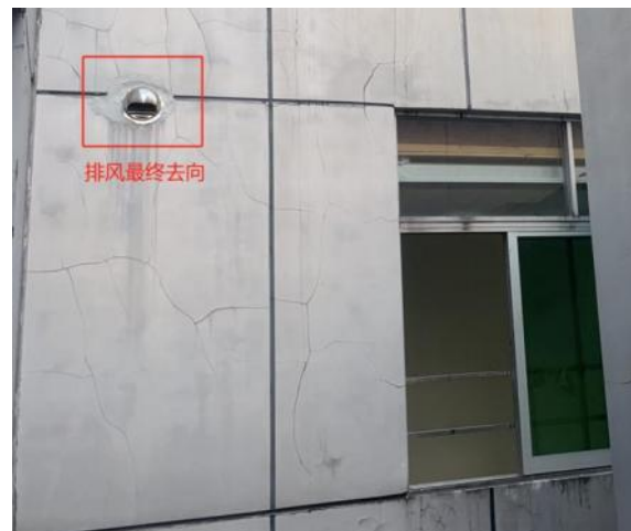
排风口外部照片
