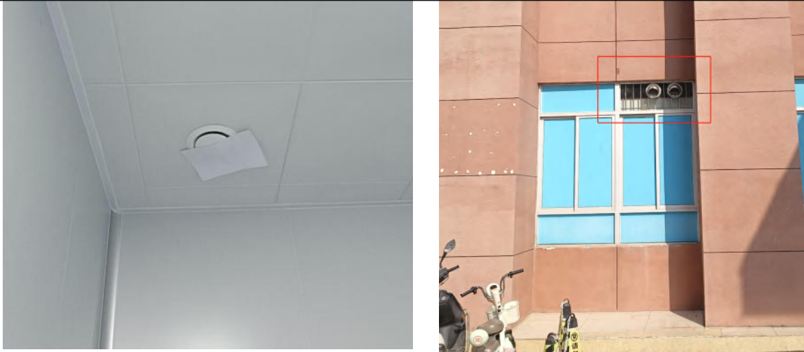
图 3-9 通风口现场照片
