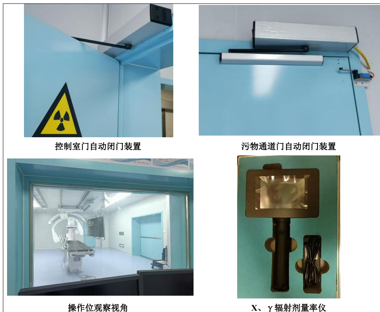
图 3-5 本项目机房安全装置和警告标识现场图
