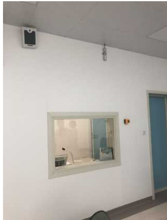
东墙急停开关
