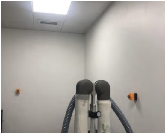
西墙和南墙急停开关
