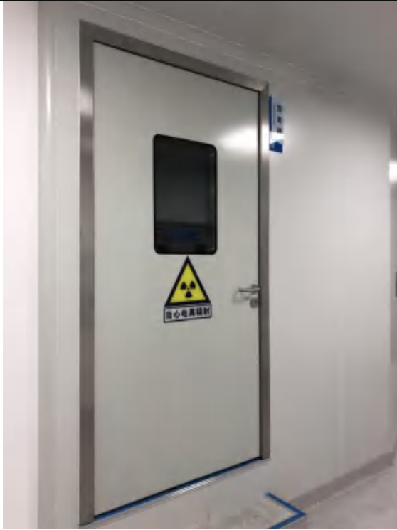
固废间门牌和电离辐射警告标志
