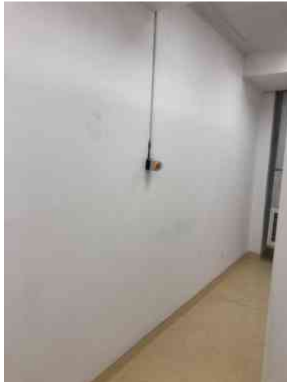
回旋加速器机房西北墙急停按钮
