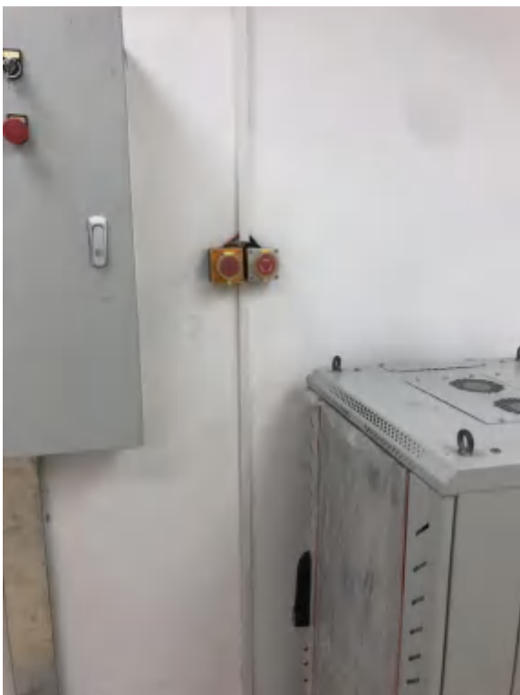
回旋加速器机房西南墙急停按钮和巡检按钮
