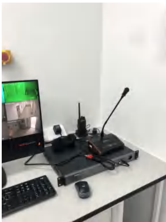
回旋加速器通讯喇叭（控制室）
