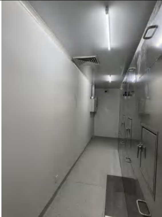
正电子药物生产车间后区排风
