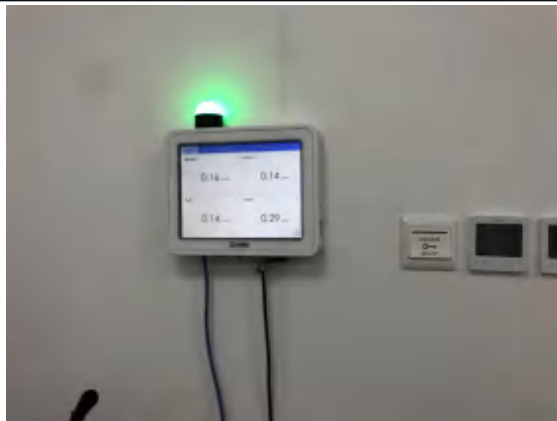
固定式场所剂量监测装置（控制室内）
