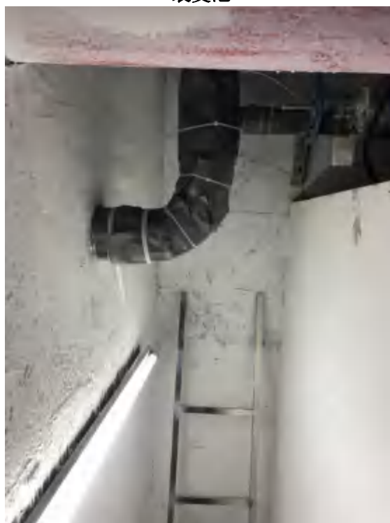
排水管道屏蔽补偿
