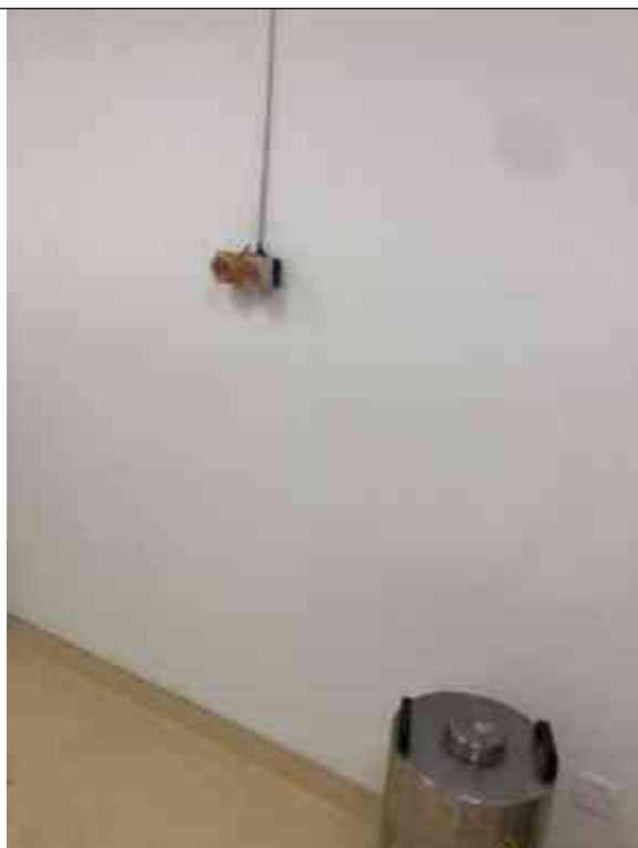
回旋加速器机房东北墙急停按钮和巡检按钮
