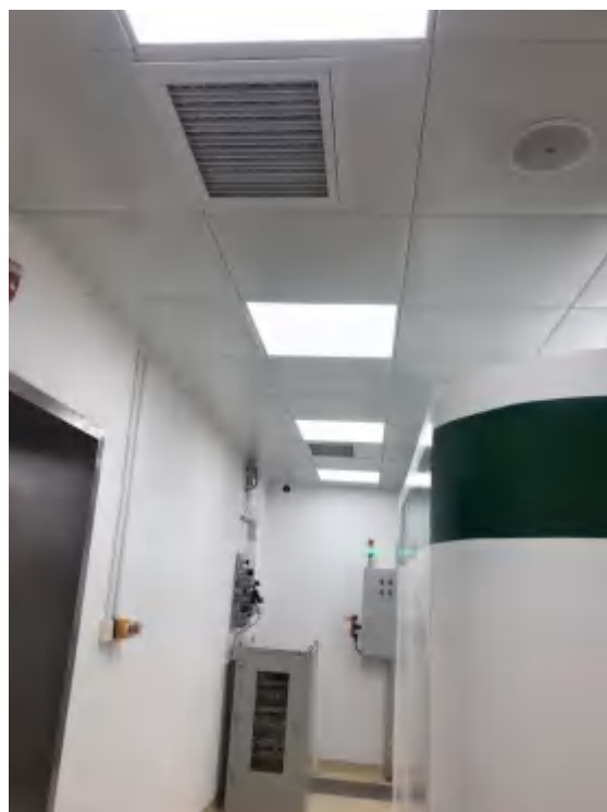
回旋加速器机房东南墙急停按钮（防护门旁）和巡检按钮
