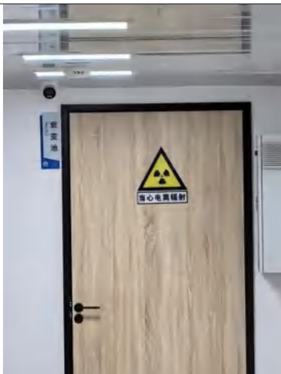
衰变池间门牌和电离辐射警告标志
