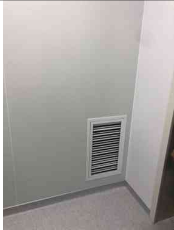
正电子药物生产车间排风
