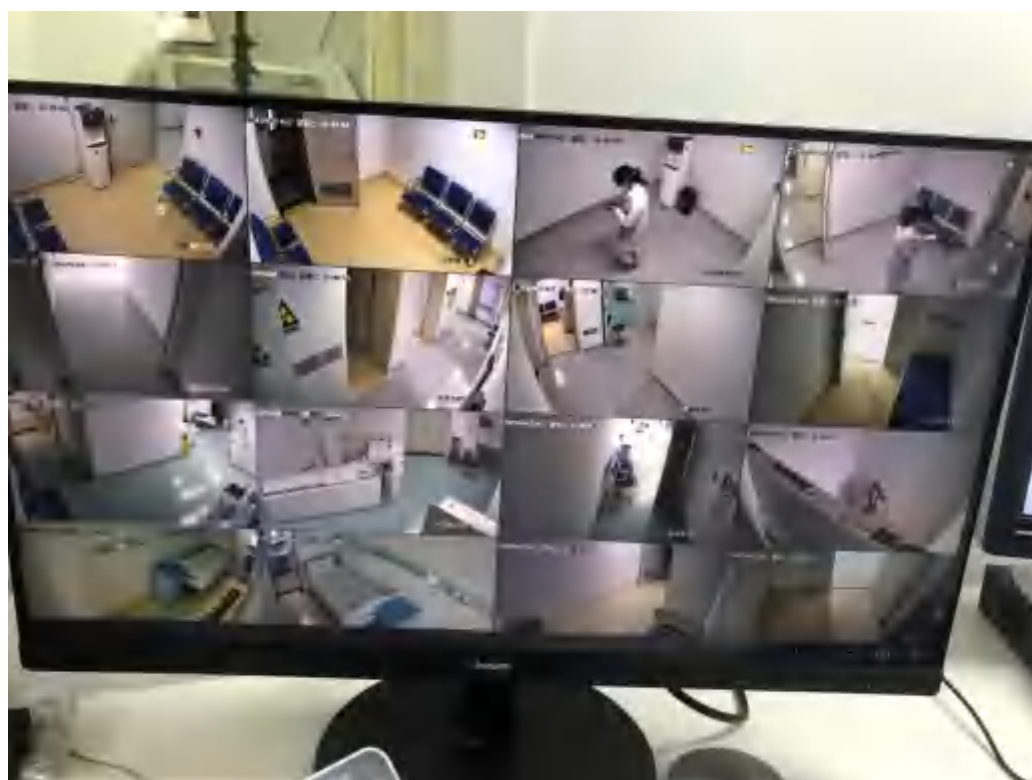
监控显示器（位于 SPECT/CT 操作室）
