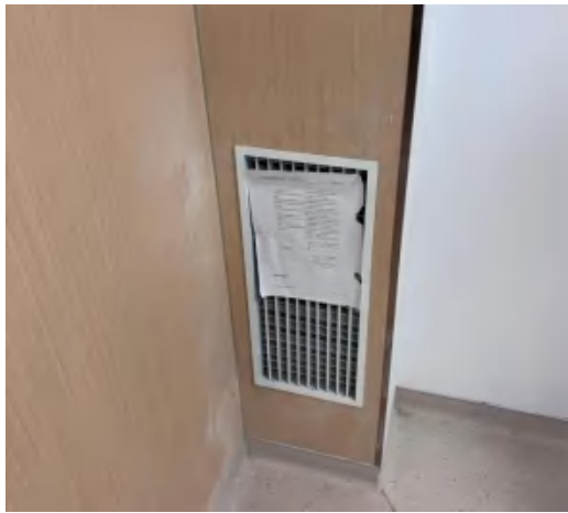
CT 模拟定位室下排风口
