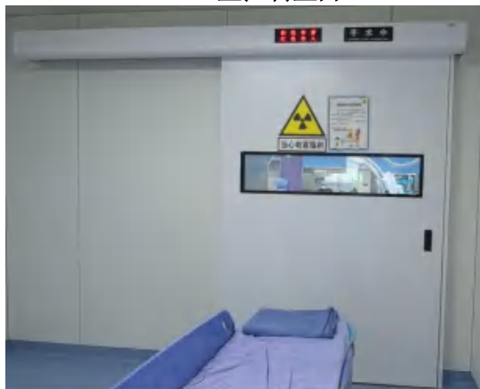
DSA3 室机房大门闭合状态
