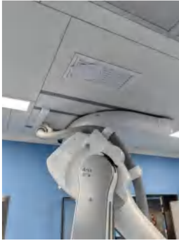
DSA2 室排风口照片
