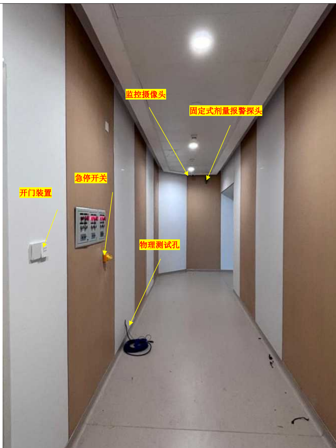
4 号直线加速器机房迷道安全装置
