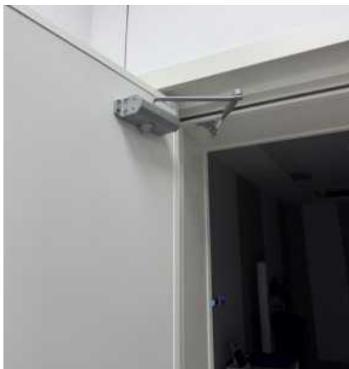
操作室防护门自动闭门装置
