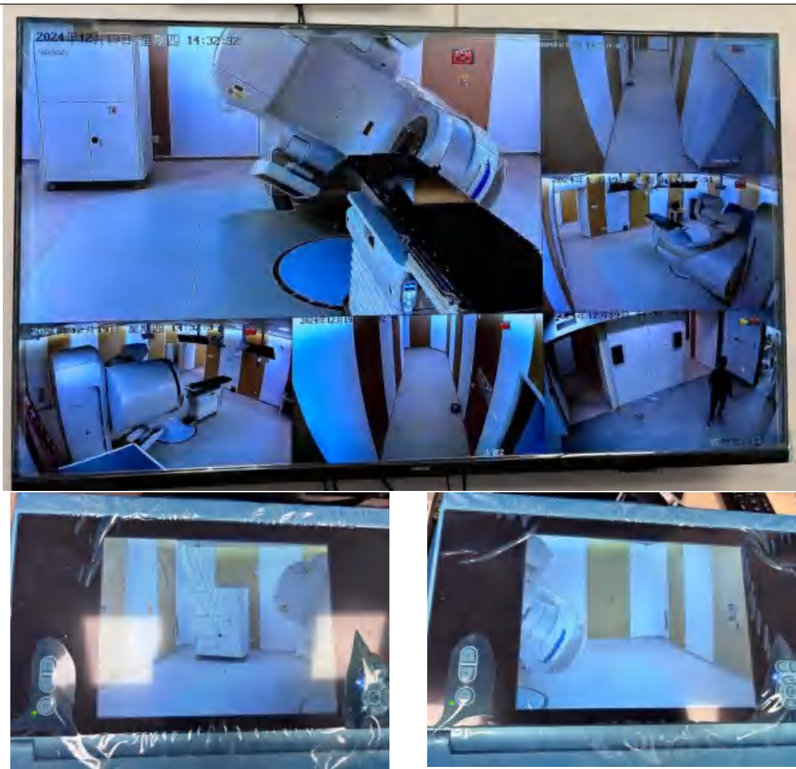
操作室监控显示器（3号加速器机房）
