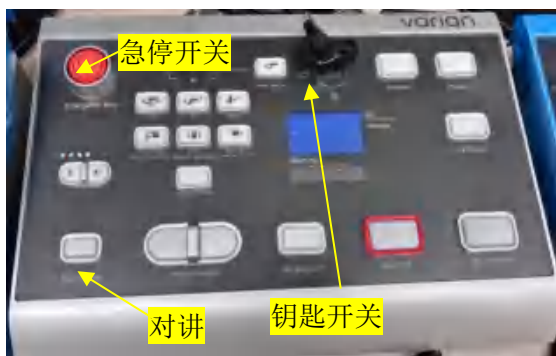
控制面板（3号加速器机房）
