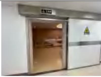
机房大门开启情况
