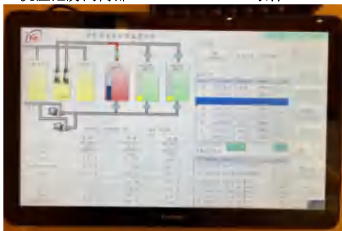
衰变池控制面板（位于3楼护士站）
