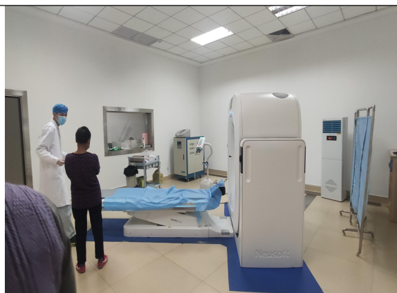
医技楼一楼CT检查室2CT
