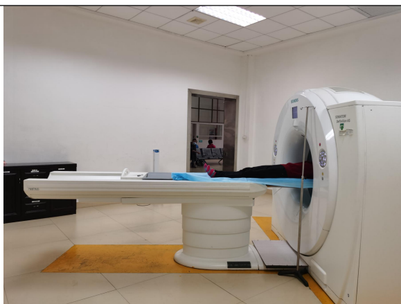
医技楼一楼CT检查室1CT
