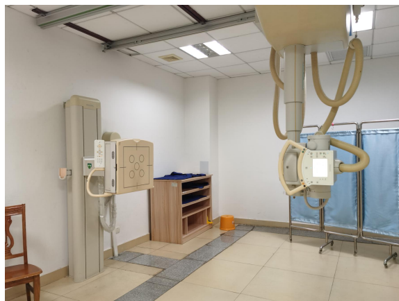
医技楼一楼照片室（2）DR
