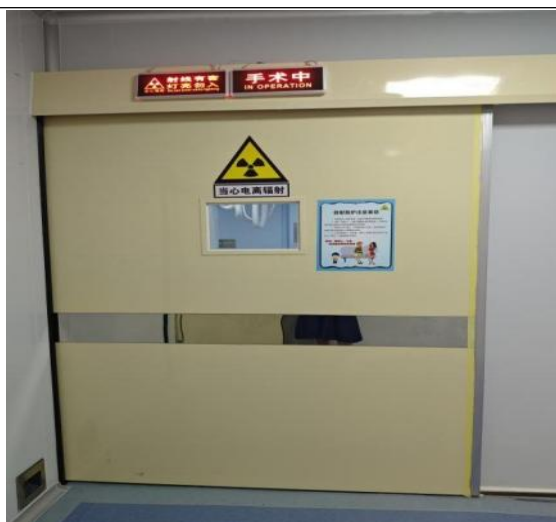
机房大门开启状态
