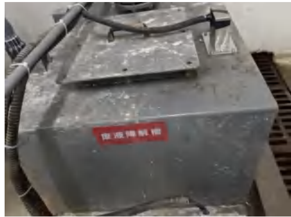
D 栋负二层废液降解槽
