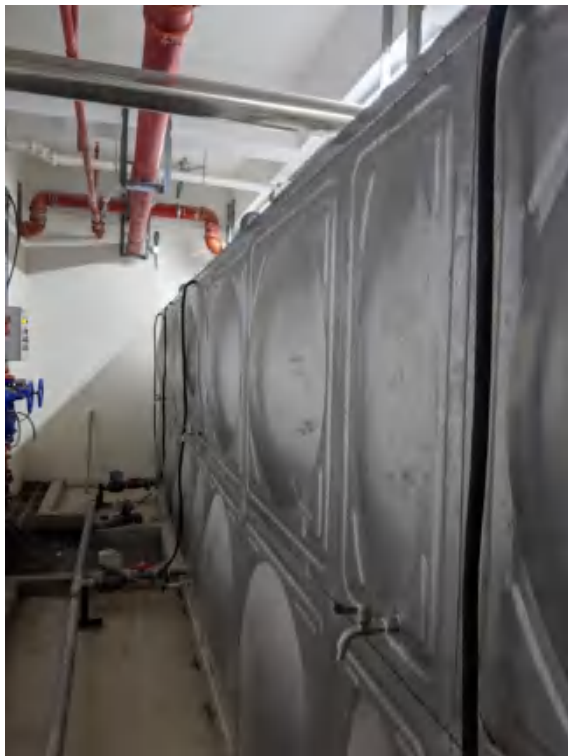
D 栋负二层放射性废水处理间
