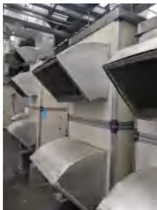
D 栋屋顶总排风出口
