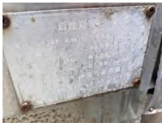
D 栋屋顶排风管道活性炭吸附塔
