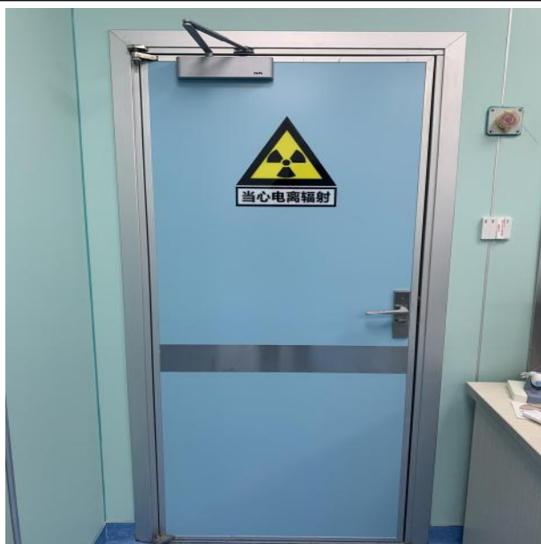
控制室门及自动闭门装置
