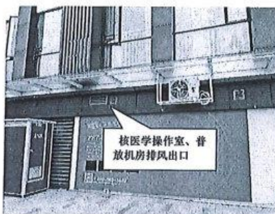
核医学操作室、普放机房排风出口
