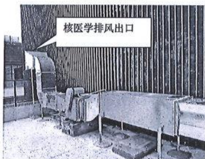
核医学工作场所楼顶排风管道
