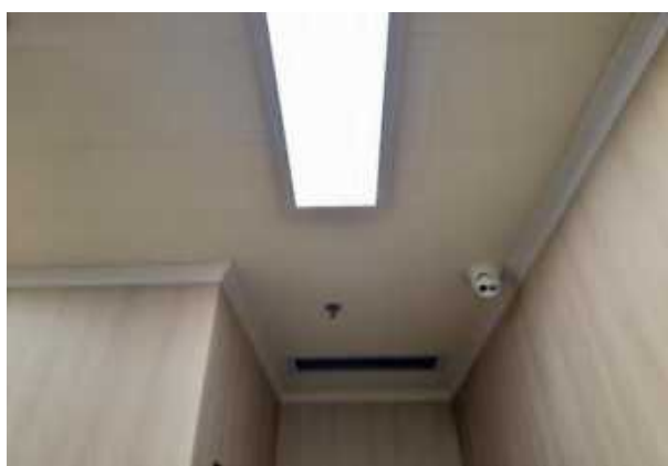
敷贴治疗室通风口
