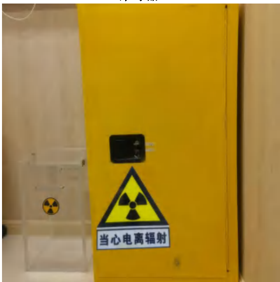
敷贴室有机玻璃废物桶、储源保险柜
