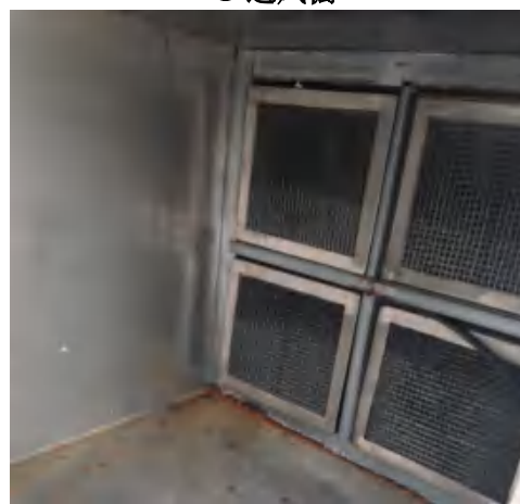
楼顶排风口活性炭过滤箱
