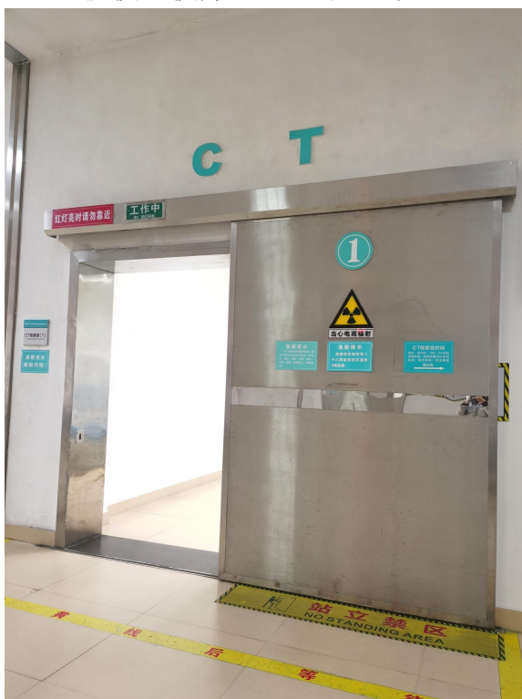
医技楼一楼CT检查室1（开门状态）
