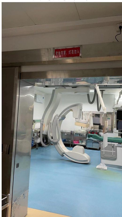
住院楼四楼DSA机房大门（开门状态）
