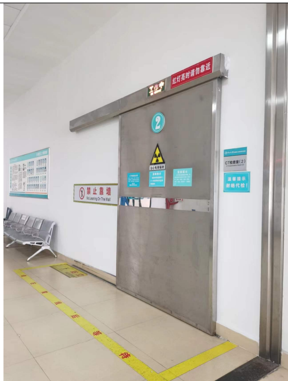
医技楼一楼CT检查室2（关门状态）
