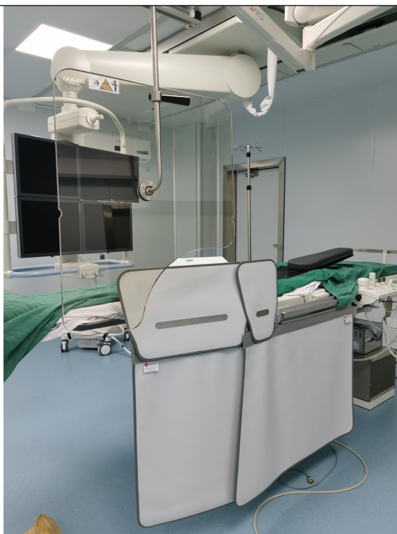
医技楼一楼介入1室防护用品
