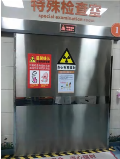
机房大门关闭
