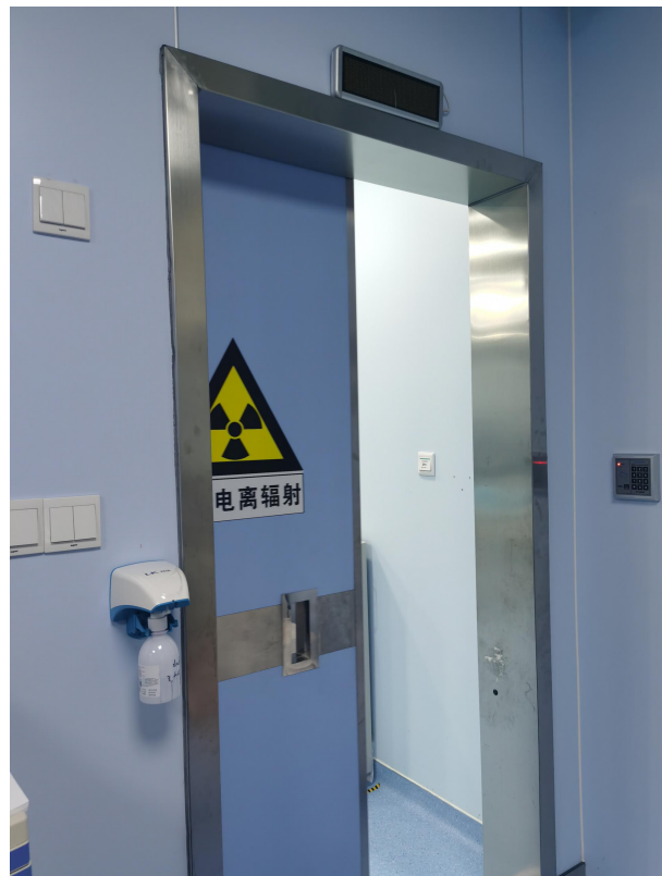
DSA机房操作室门（开门状态）
