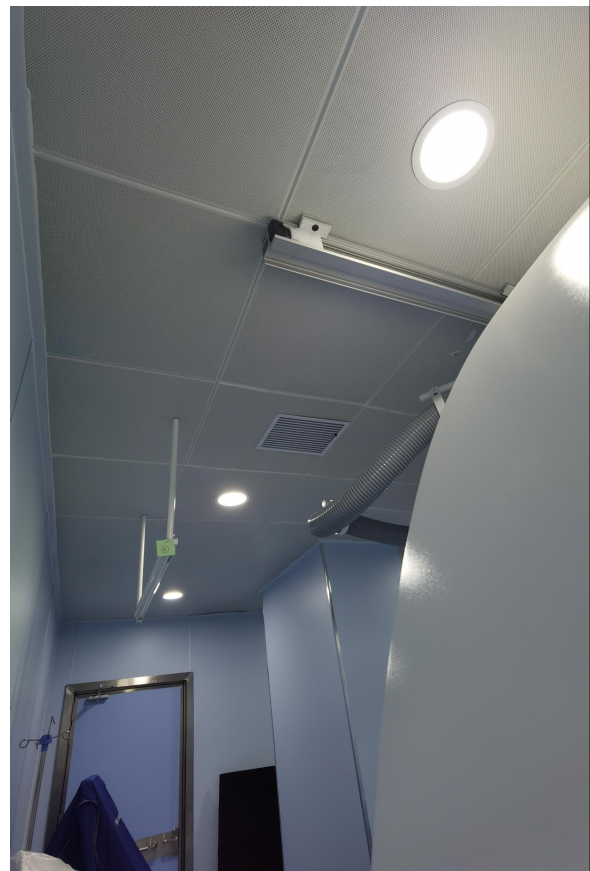
DSA 机房排风口
