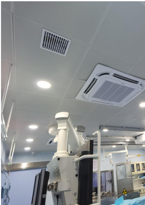
DSA 机房排风口
