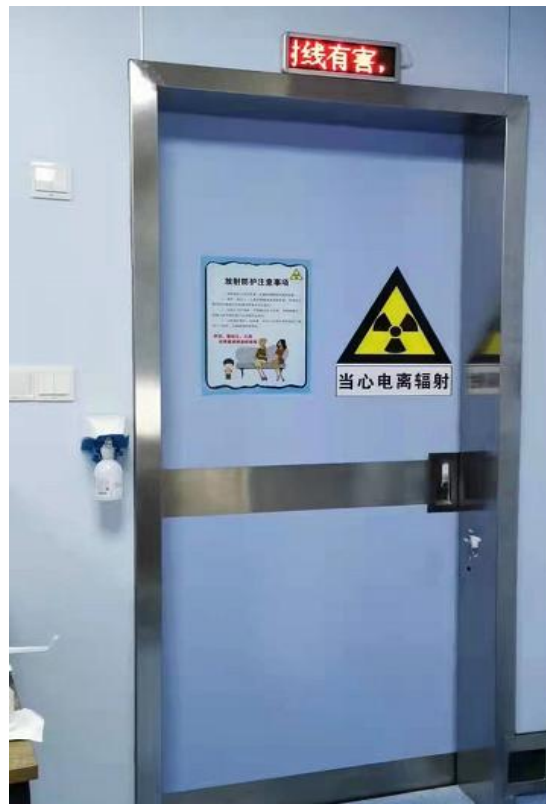
DSA机房操作室门（关门状态）
