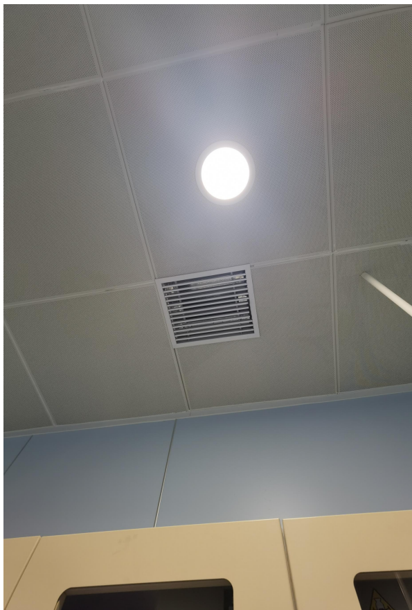
DSA 机房排风口
