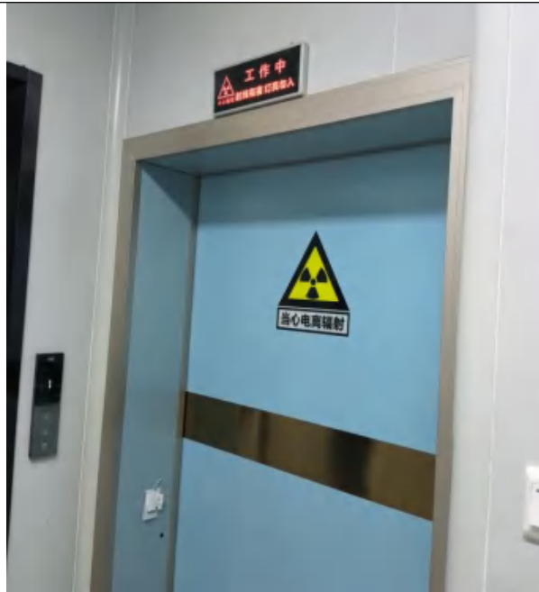
CT室机房大门闭合
