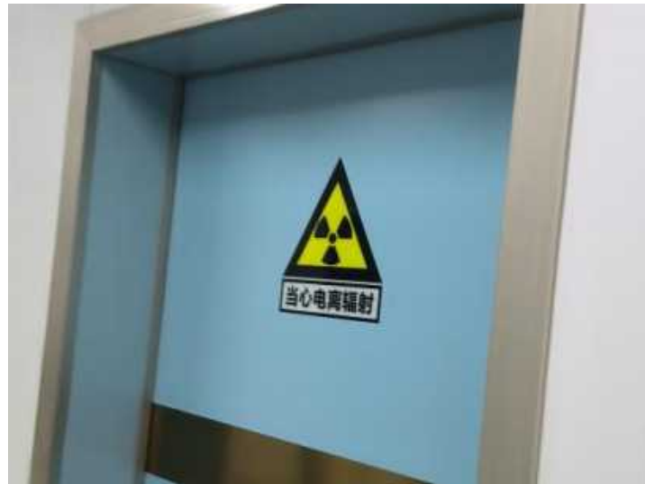
控制室门电离辐射警告标志
