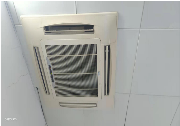
住院楼四楼DSA机房排风口
