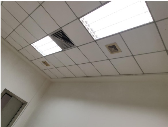
医技楼一楼CT检查室1排风口
