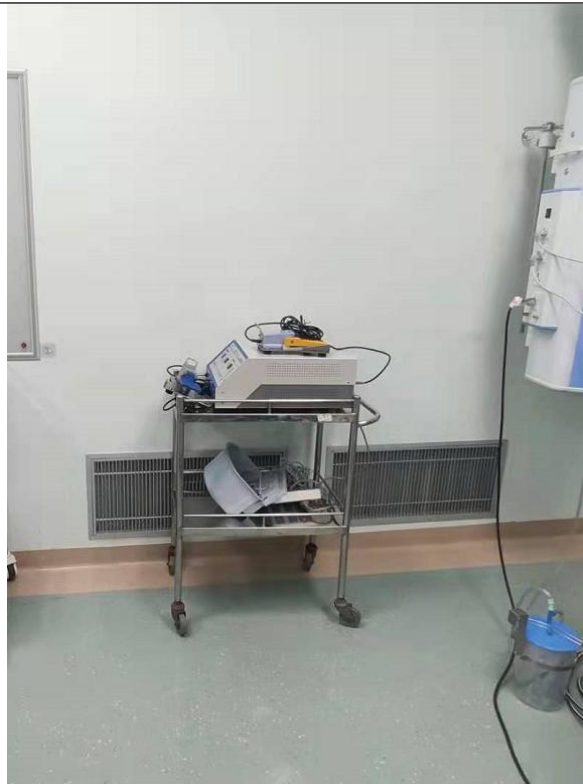
住院楼十三楼手术室1排风口
