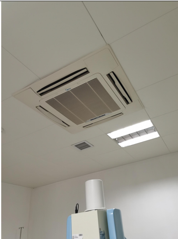
住院楼十楼碎石室排风口
