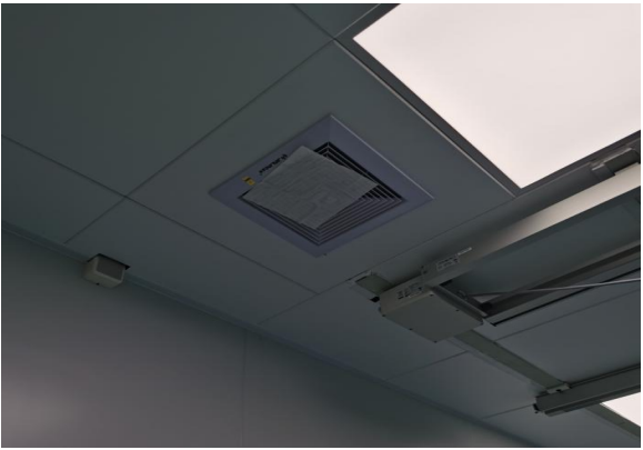
医技楼一楼介入1室排风口
