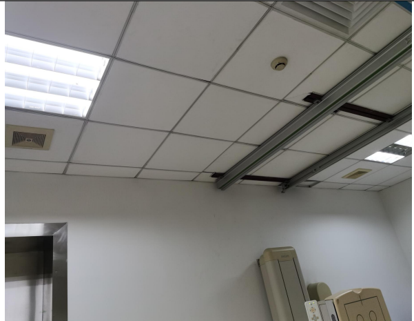
医技楼一楼照片室（2）排风口
