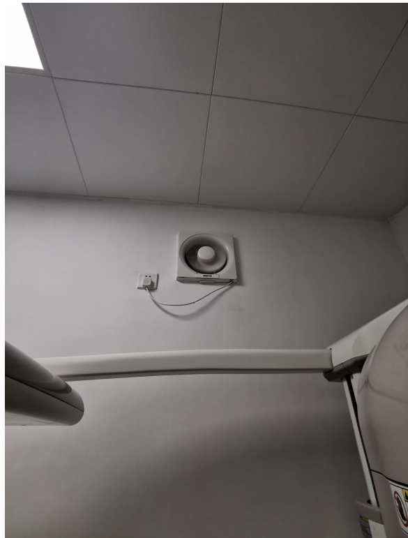
门诊楼三楼口腔 CBCT 室排风口
