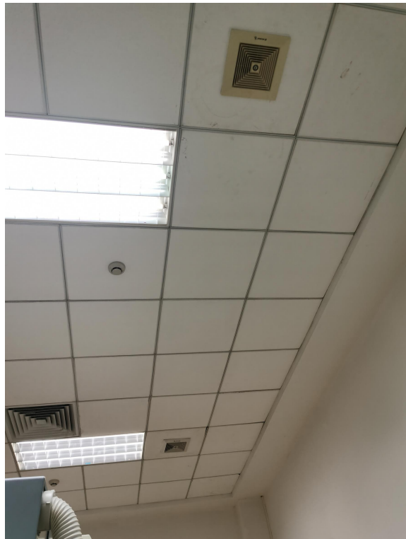
医技大楼一楼透视胃肠室（1）排风口
