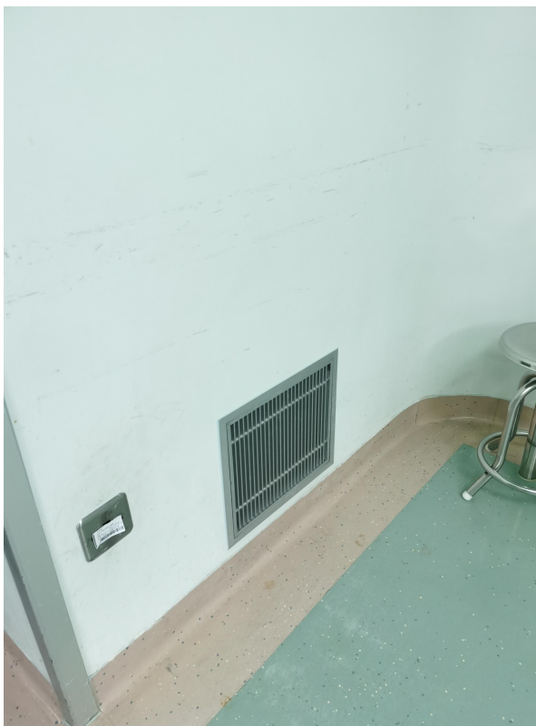
住院楼十三楼手术室17排风口
