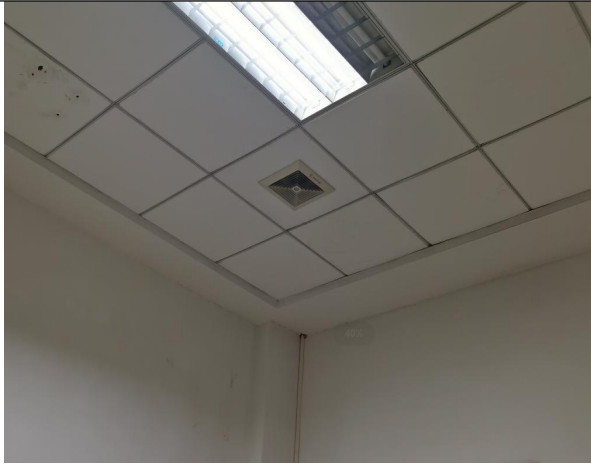
医技楼一楼照片室（1）排风口
