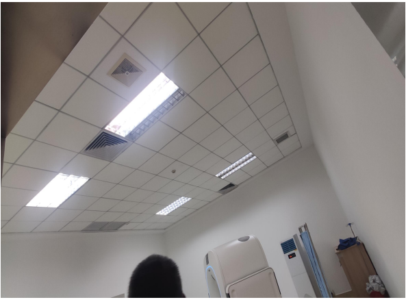
医技楼一楼CT检查室2排风口
