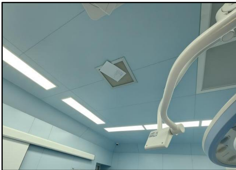
图 3-5 本项目机房通风设置现场照片
