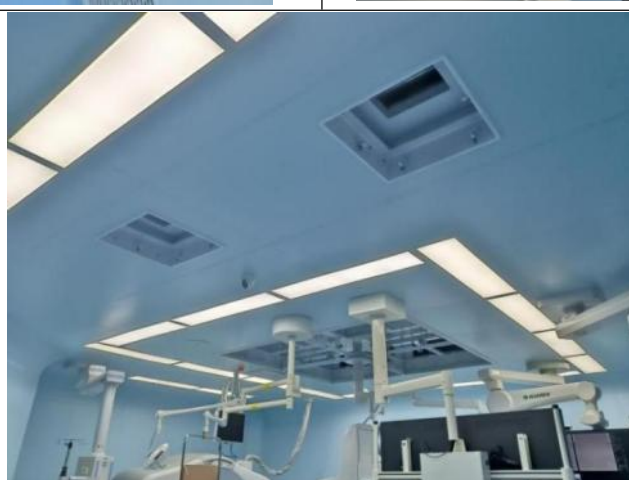
图 3-5 本项目机房通风设置现场照片
