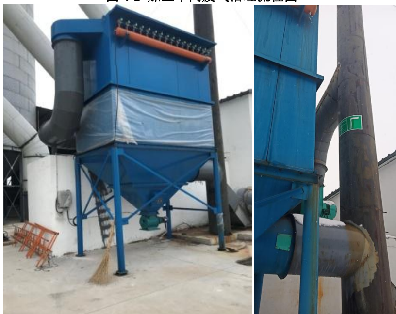
图 4-3 烘干炉除尘器及排气筒
