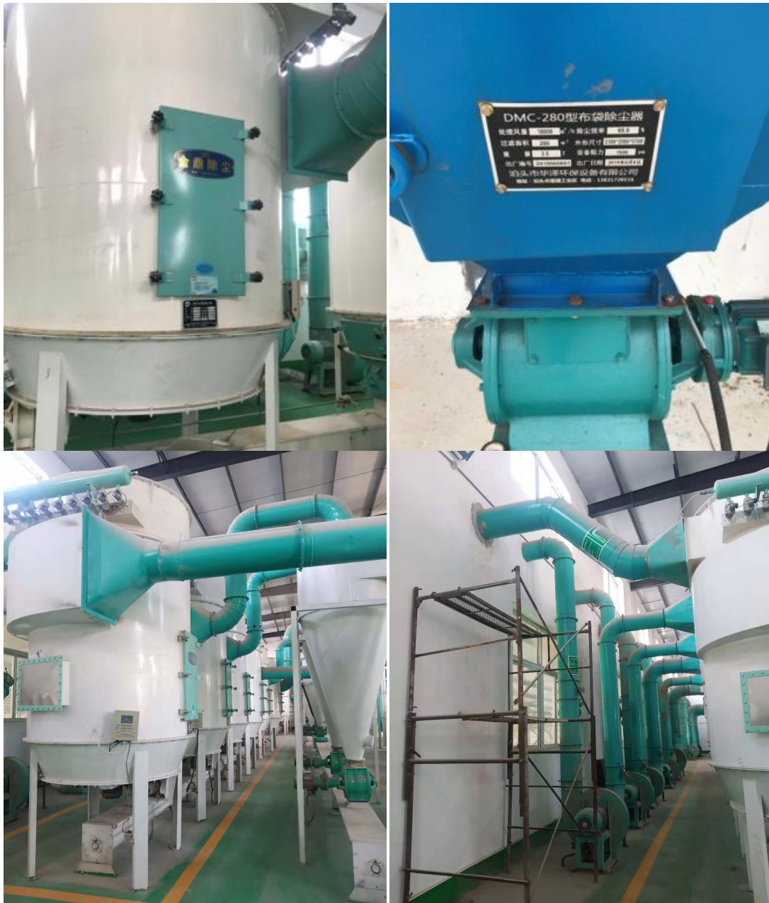
图 4-6 大米加工车间除尘器及排气筒
