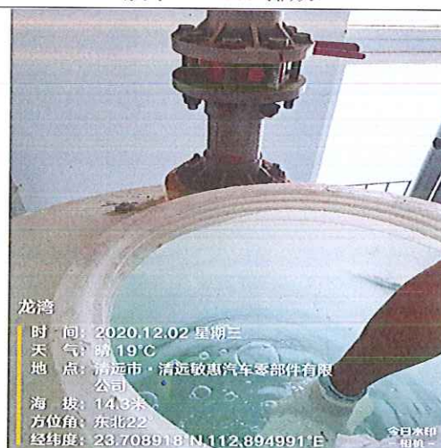
含镍车间废水排放口
