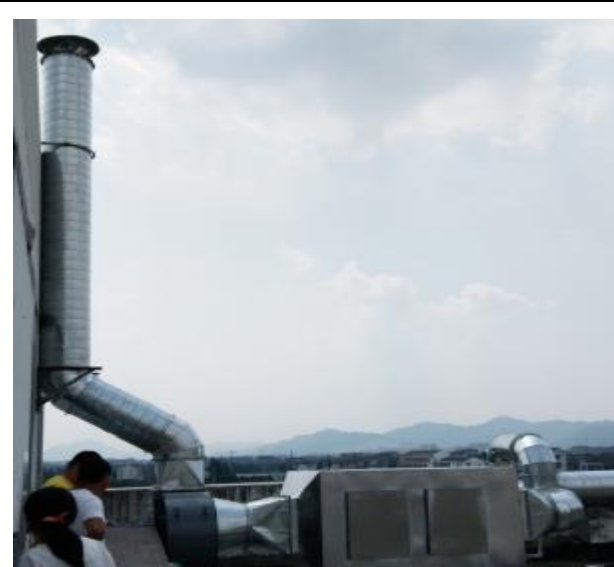
水墨印刷废气处理设施
