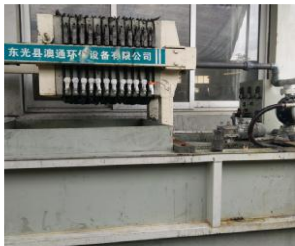
水墨印刷废水净化装置
