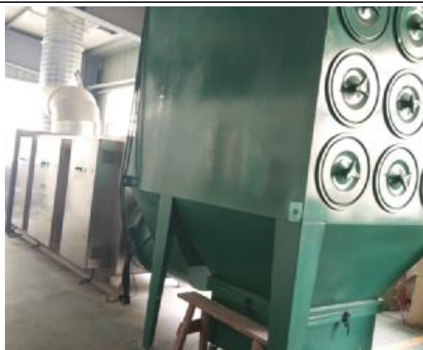
胶印废气处理设施
