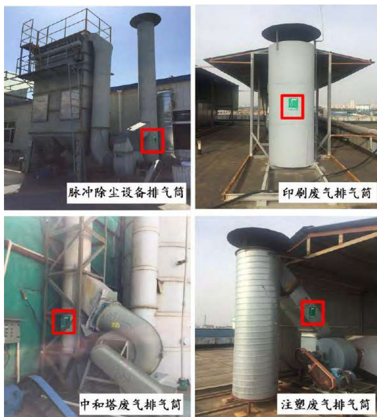
图 14.4-2 废气排放口规范化情况
