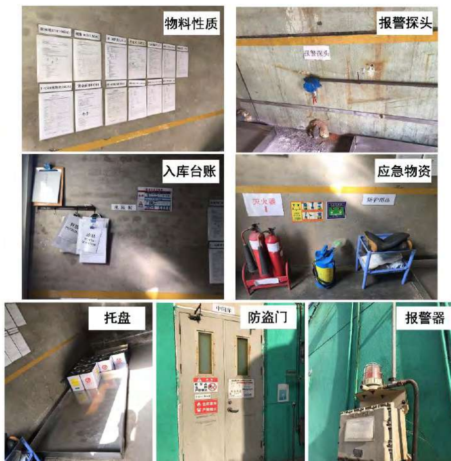
图 12.5-2 中间库现有风险防范、应急措施
