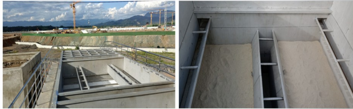
云南西双版纳一体化净水设备（V型滤池），处理量（200t/h）
