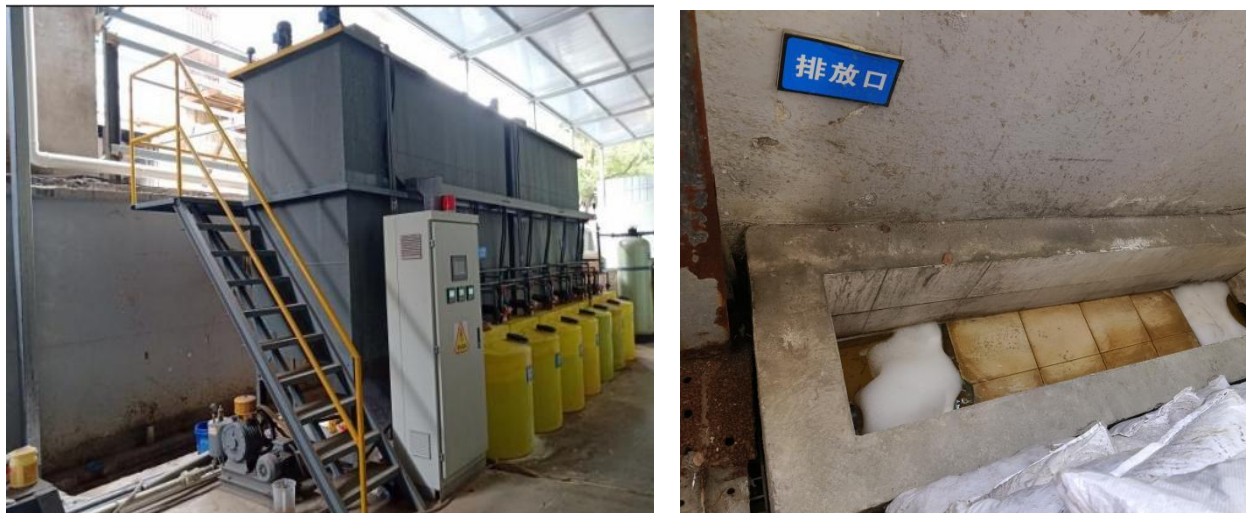
图 3-5 废水治理设施
