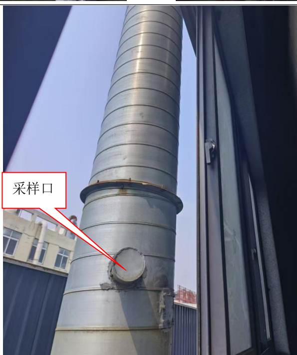
图 3-2 电泳固化废气治理设施照片
