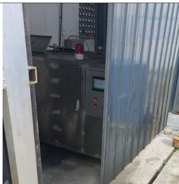
脱模剂过滤回收系统
