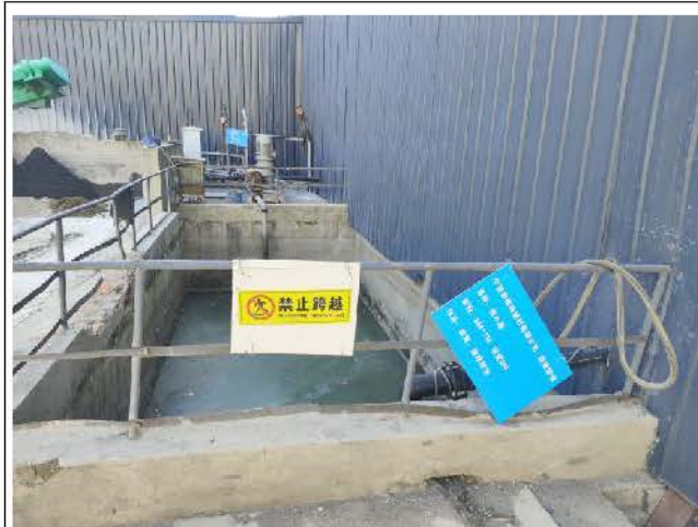
雨水池、沉淀池
