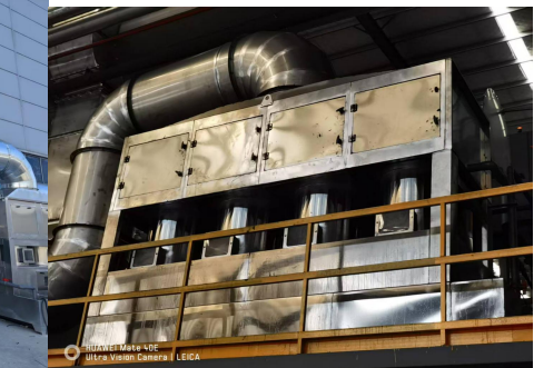
压铸废气治理设施
