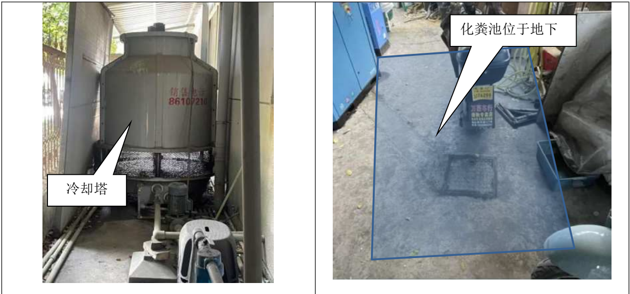
图 3-3 废水治理设施照片
