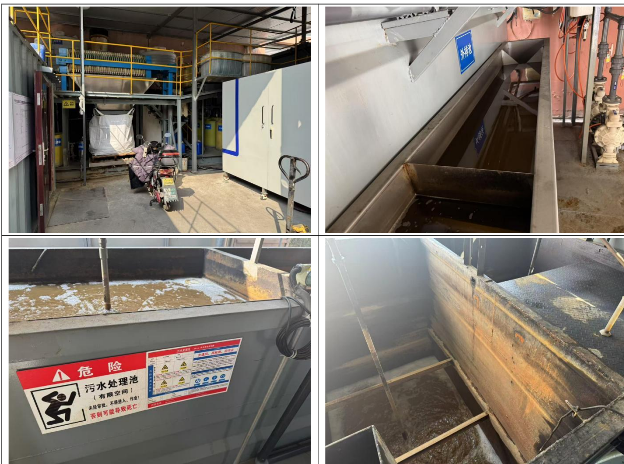
图 3-2 污水处理站及废水排放口照片
