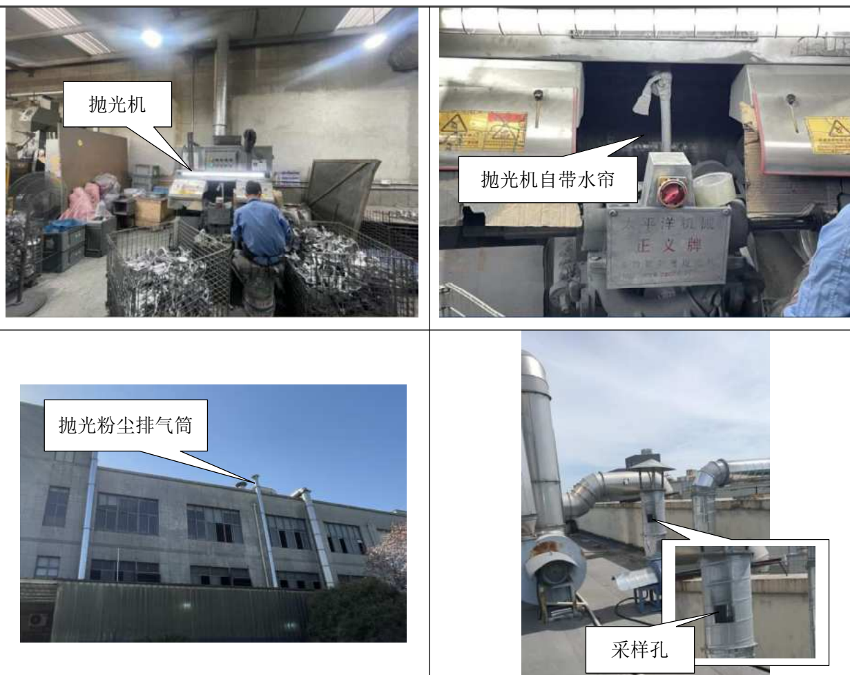
图 3-6 抛光粉尘治理设施照片
