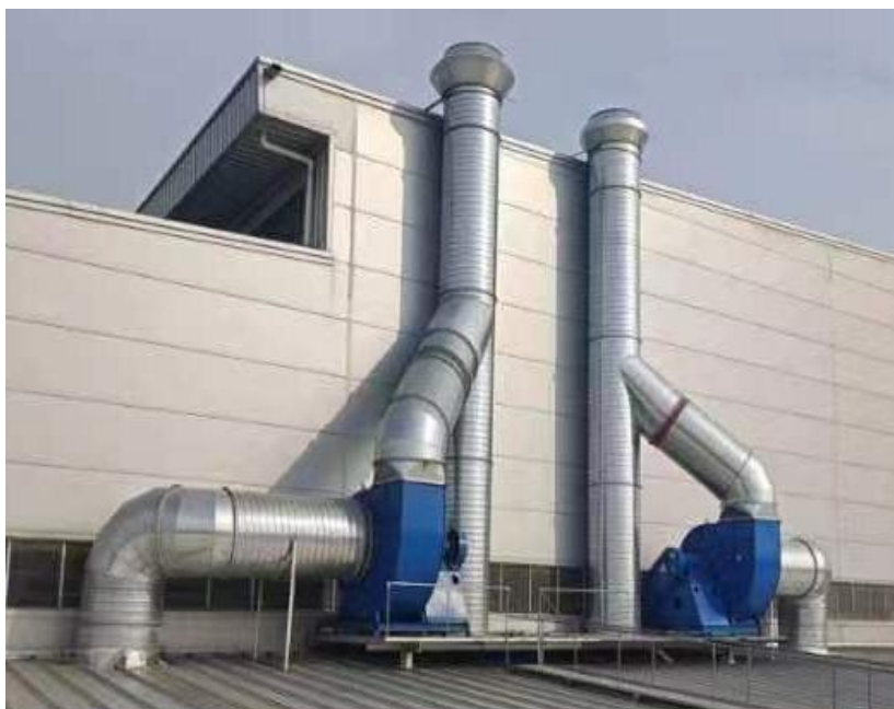
C 车间焊接烟尘排气筒
