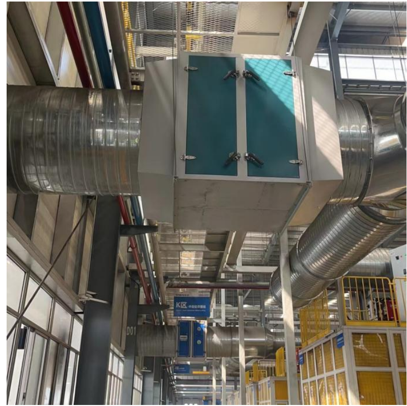
C 车间焊接烟尘治理设施
