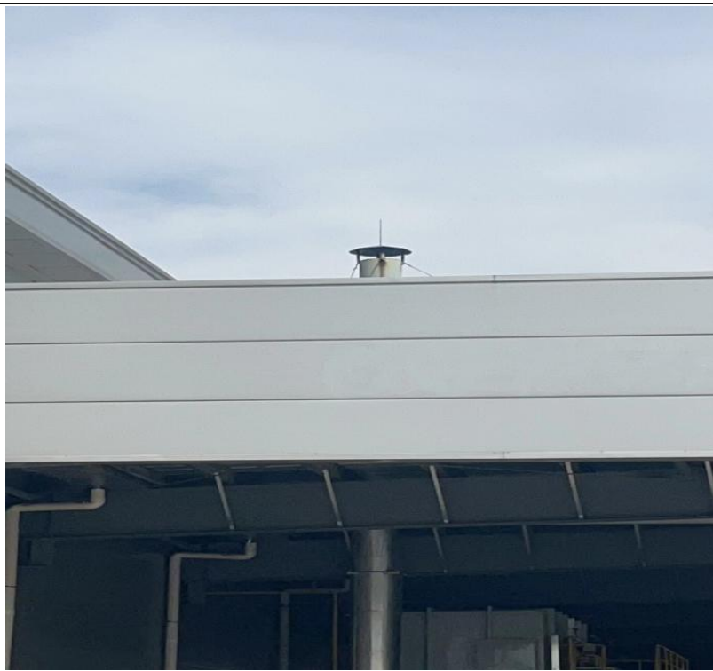
C 车间天然气燃烧废气排气筒
