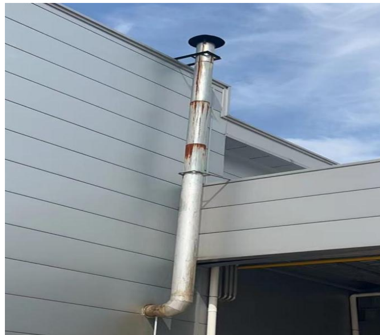
C 车间天然气燃烧废气排气筒
