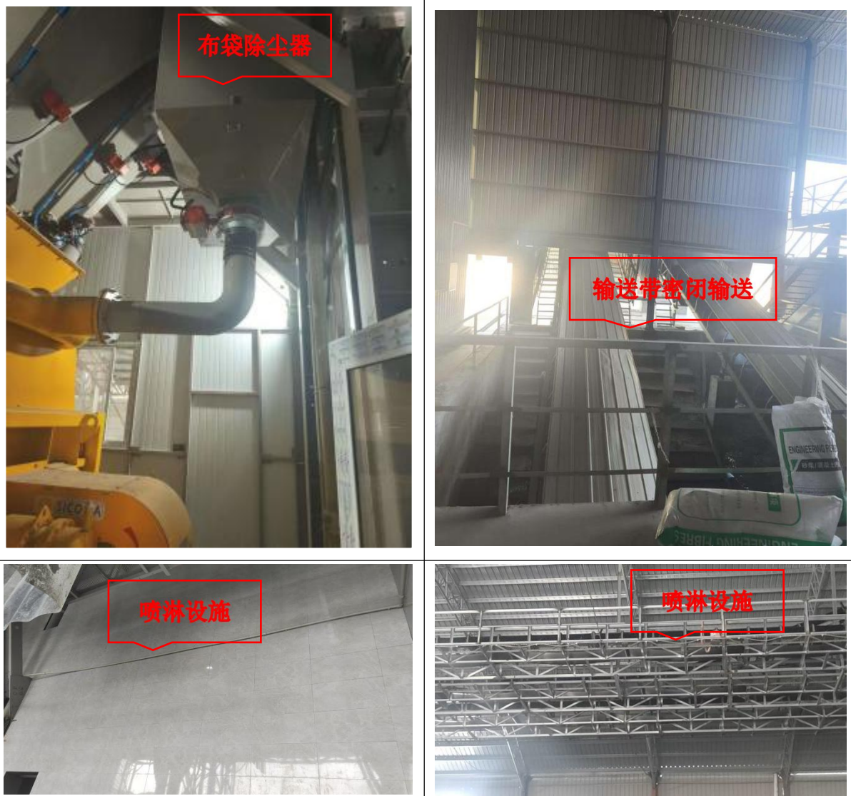
图 3-1 厂区废气治理设施照片
