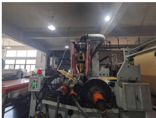
图 3-2 废气治理设施照片
