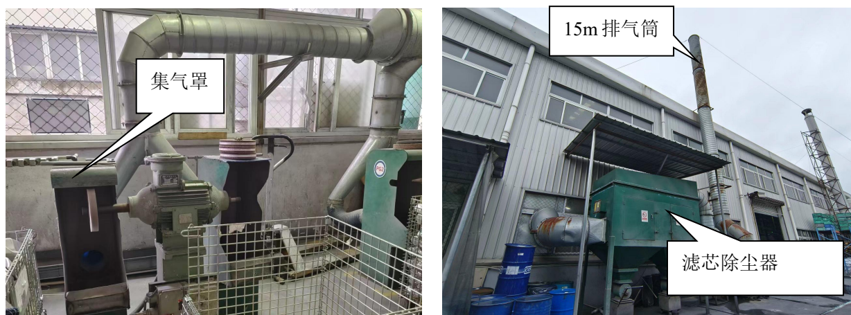
图 3-6 抛光粉尘治理设施照片
