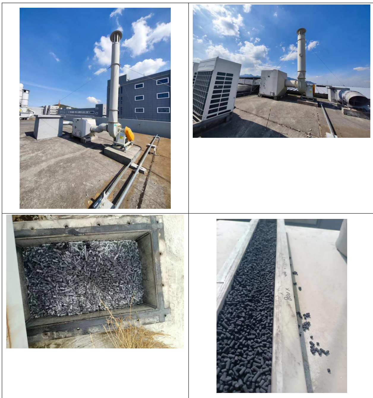
图 3-4 实验室废气治理设施照片
