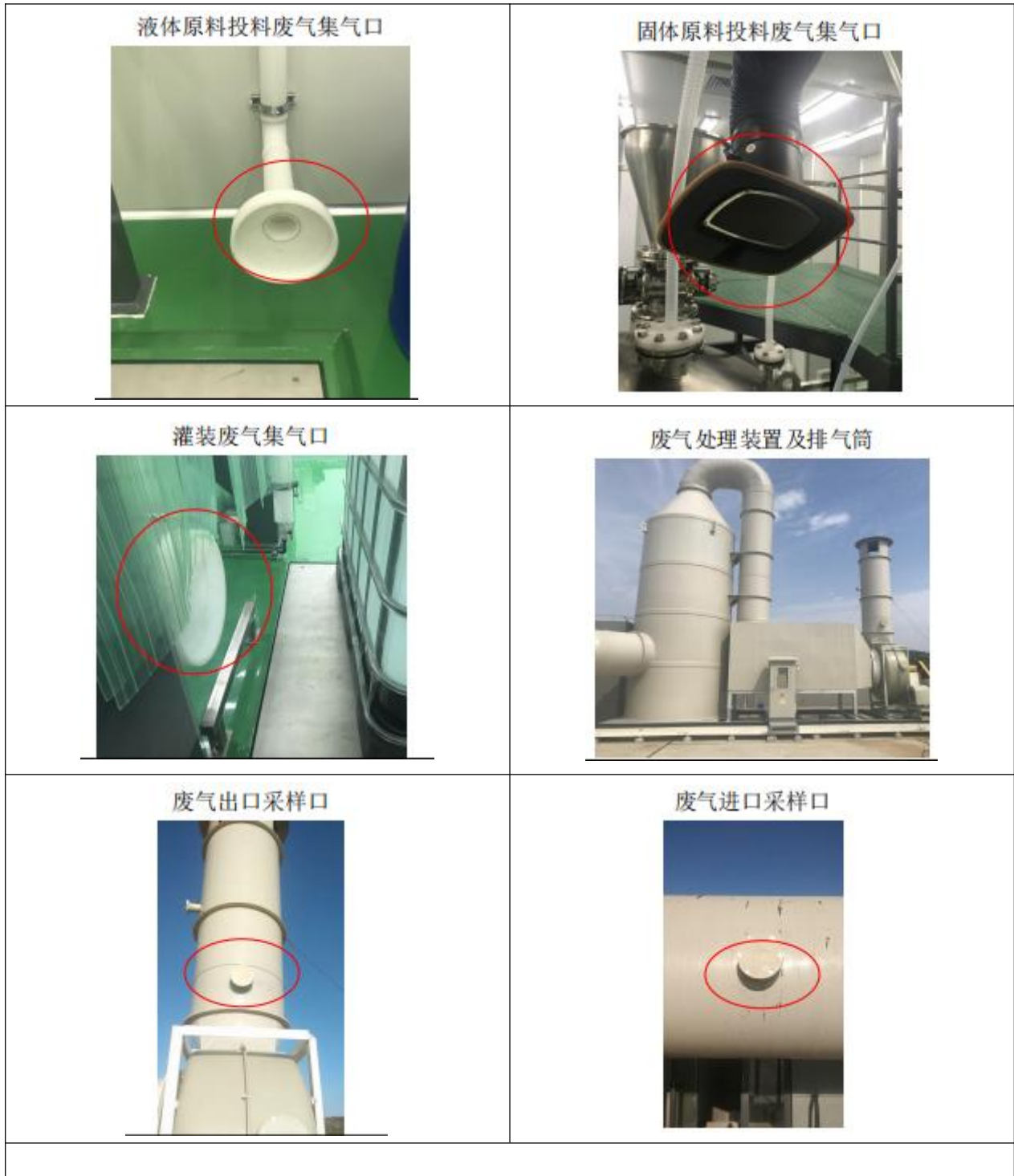
图 3-2 生产车间废气（投料废气、混合废气、灌装废气）治理设施照片
