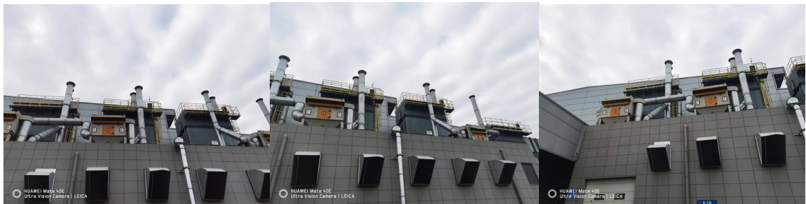
混砂粉尘、制芯粉尘治理设施
