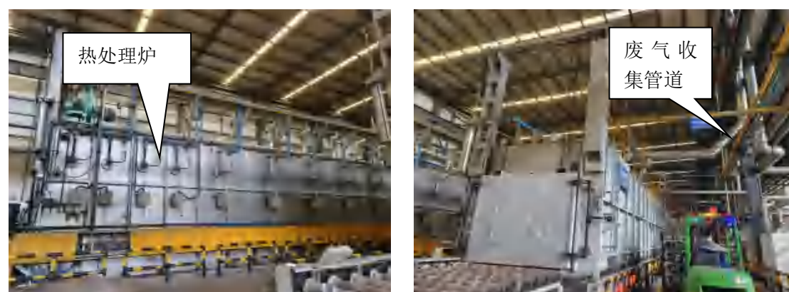
图4.1-9 四号车间热处理天然气燃烧废气治理设施照片
