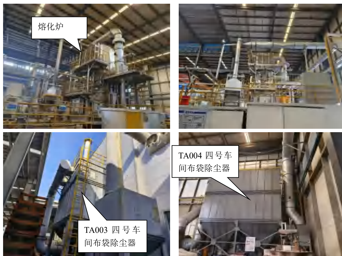
图4.1-8 四号车间铝锭熔融废气治理设施照片
