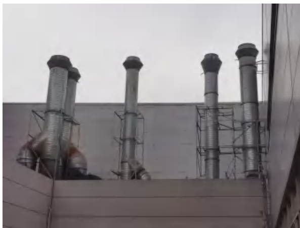
图4.1-4 一号车间焊接废气治理设施照片
