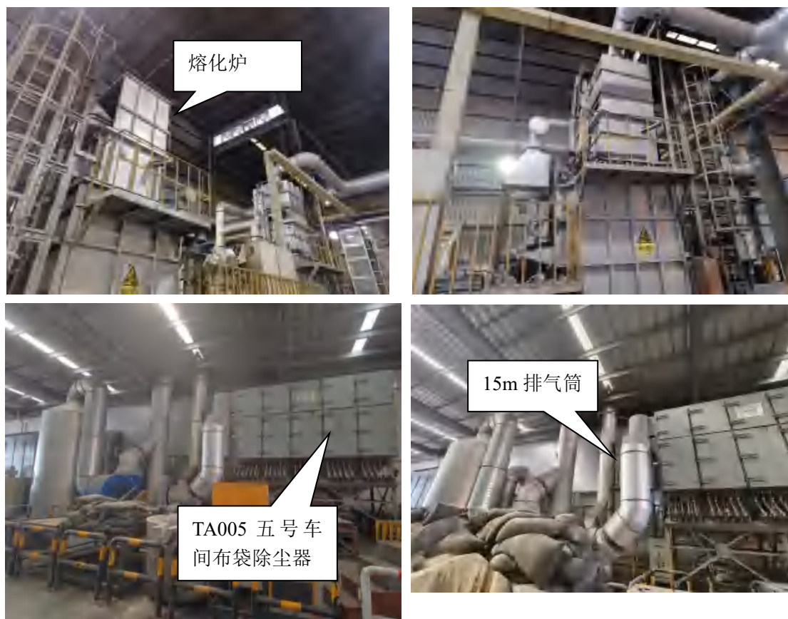
图4.1-10 五号车间铝锭熔融废气治理设施照片
