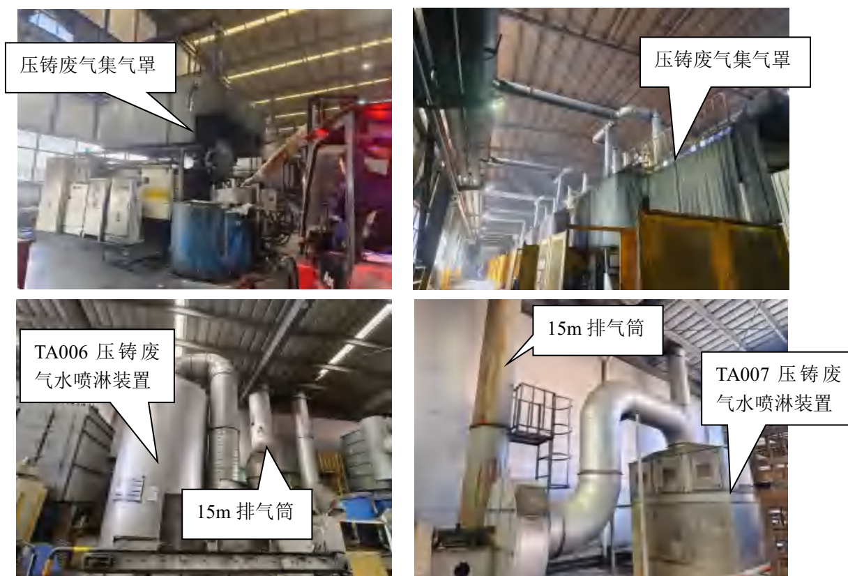
图4.1-11 五号车间压铸脱模废气治理设施照片
