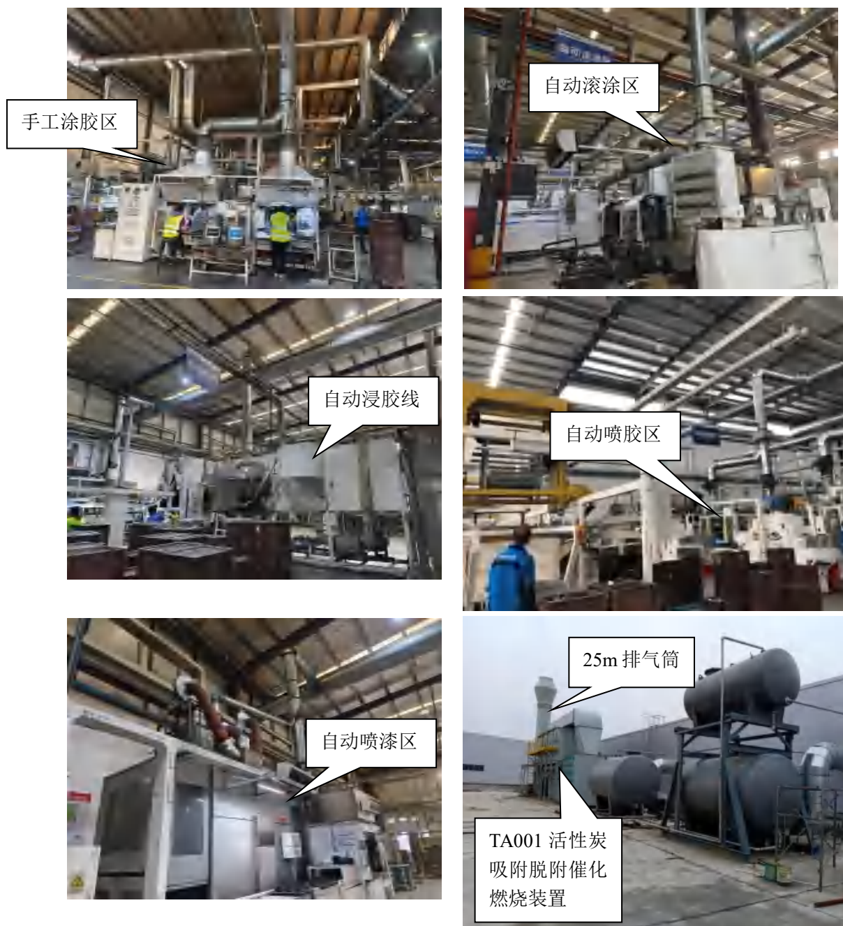
图4.1-6 二号车间上胶废气、喷漆废气治理设施照片
